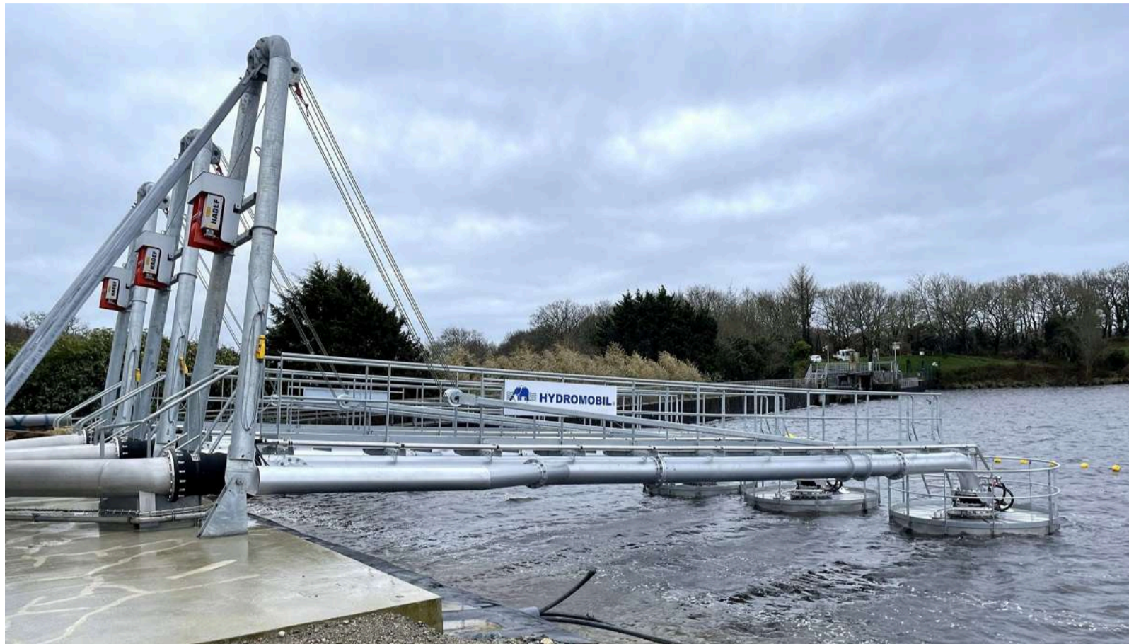
Une station de pompage en surface Hydromobil. | Photo Hydromobil by STPH
